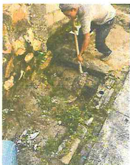
Foto1: Socavamiento en muro perimetral de 5x1 m.
